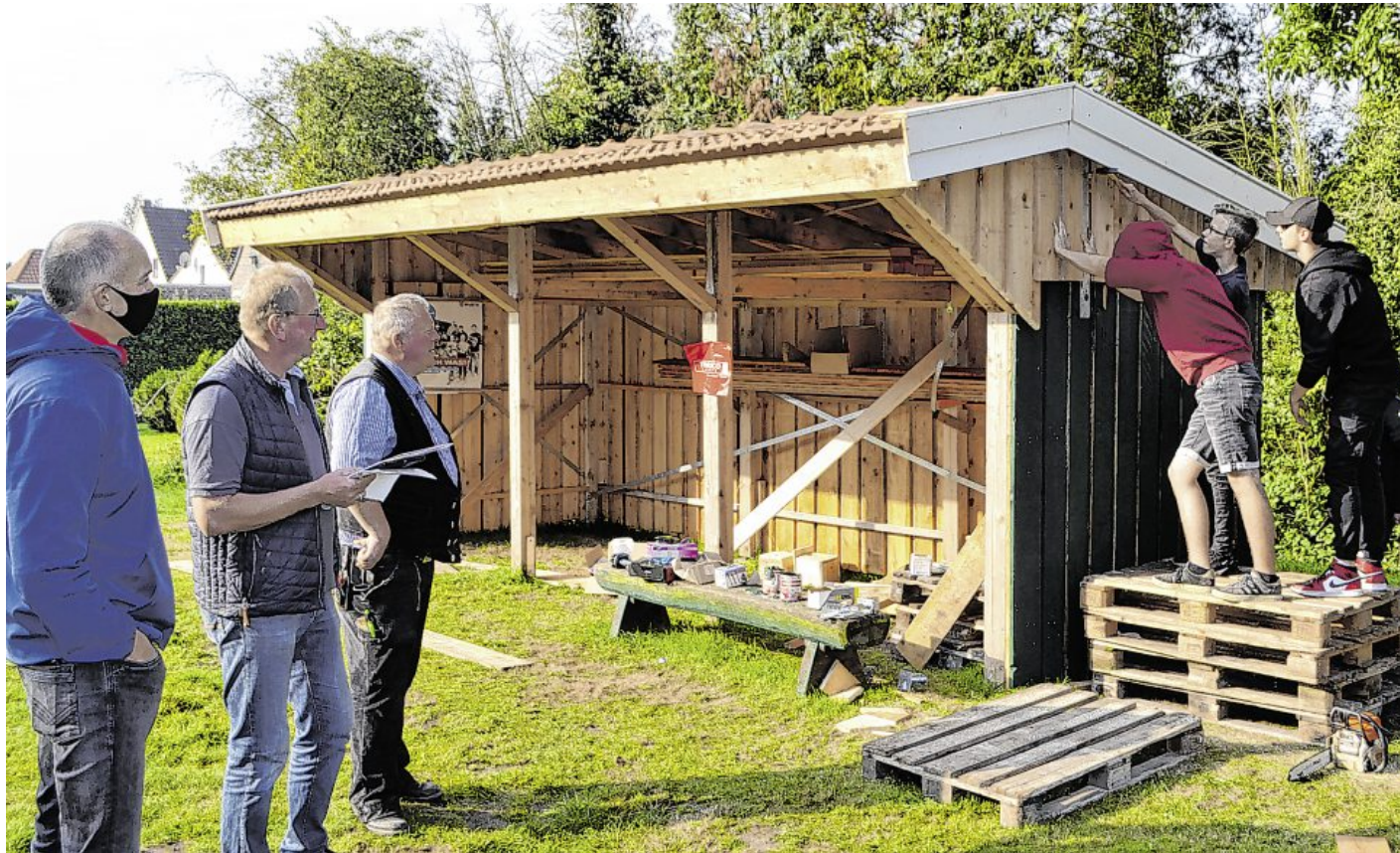
Schulleiter Ludger Mählmann (von links), Betreuungslehrer Heinz Buß und Zimmerermeister Werner Haak schauen sich an, wie die Schüler am Holz-Unterstand arbeiten.
